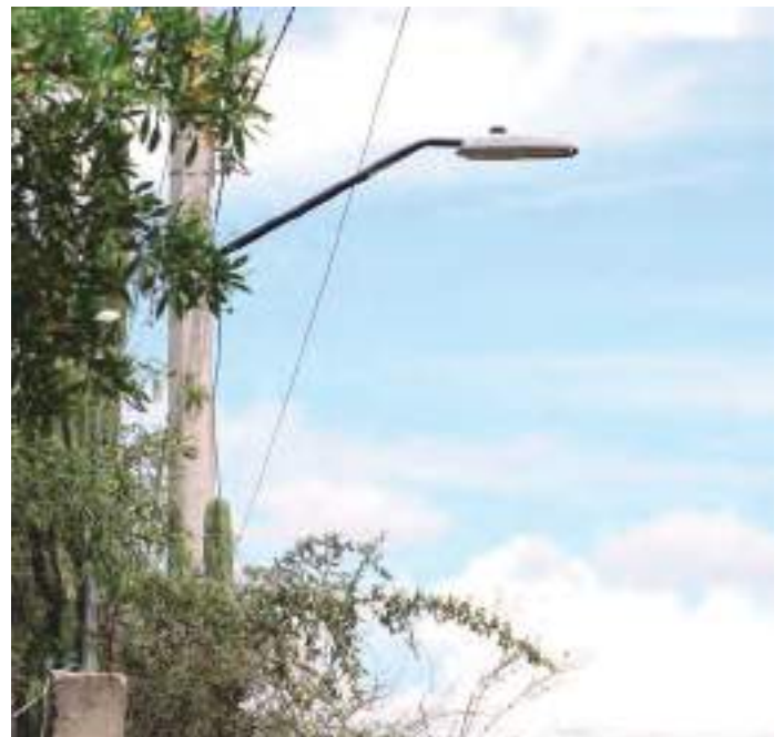
El eficiente sistema de alumbrado tipo LED también benefició a la Delegación de Villa de Pozos
