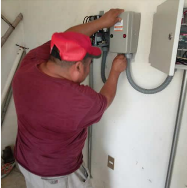
CHEQUEO DE LA CAJA DE CONTROL DE LA BOMBA DEL EJIDO LA VEGA
